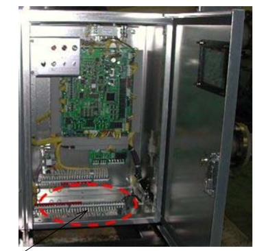
<制御箱を開いた状態>
