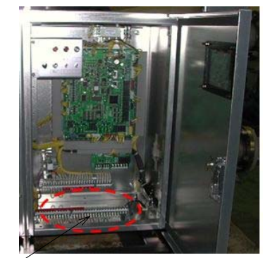
<制御箱を開いた状態>
