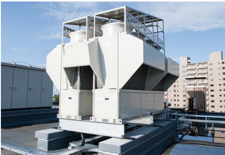
▲屋上に設置された空冷式ヒートポンプチラーDT-R(60馬力×2台)。積雪対策として防雪フード(ヤブシタ製)を装着
