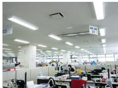
▲基準階のオフィス内、ファンコイルユニット(2方向吹出し)が均等に配置されている
