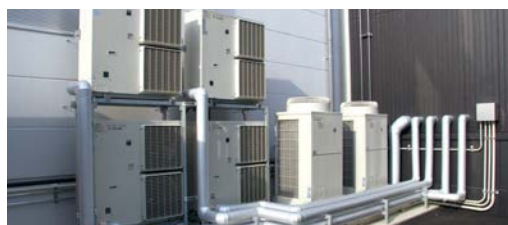
▲コンデンシングユニットは運転効率とメンテナンス性を考慮して、一部は地上設置とした
