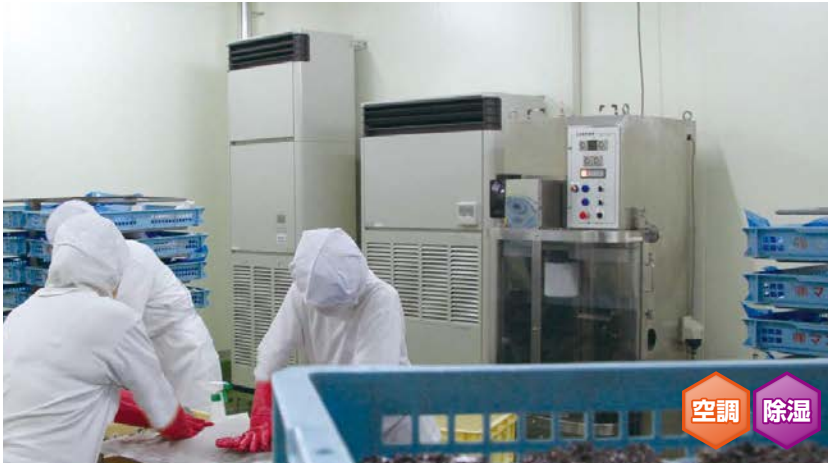
設備用パッケージエアコンと産業用除湿機で、餅製造室の温湿度を一定に管理
