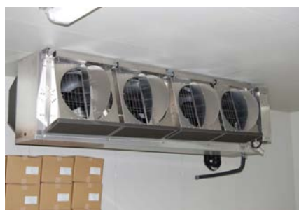
▲原料保管庫内には当社製冷凍用ユニットクーラを2台設置。原料の劣化を防ぐため-20℃で保管。
