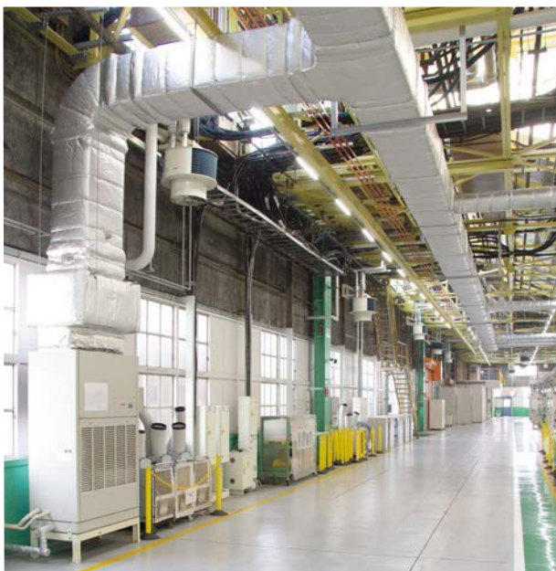
▲第10機械工場生産ラインのダクト空調として採用された、設備用パッケージエアコン「ファシレアDD」
