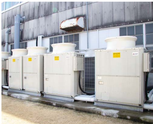
▲上郷工場の勤務体制は6:00～15:00、16:00～翌1:00の二交代制で、パッケージエアコンは作業中に稼働
