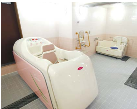
▲一階には機械浴を設置
