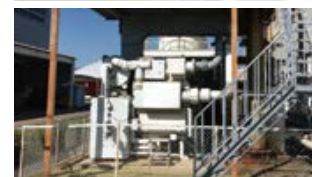
▲今回の空調設備更新に伴って撤去された、既設のガス吸収冷水機と冷却塔
