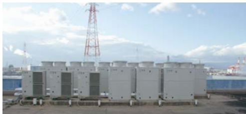
▲R410Aインバータコンデンシングユニットやビル用マルチエアコン(リブレースマルチY GR)の室外機は屋上に集中設置。既設配管の再利用で約3ヶ月の工期短縮を実現
