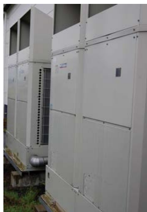
▲屋外には原料保管用冷凍庫の熱源機の当社製R410Aインバータコンデンシングユニット20馬力×2台
