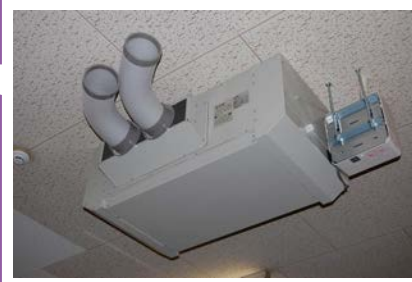
▲オプションパネル仕様で天井面ピッタリ設置。またプレナム+フレキシブルダクトで風向調整し効果的に除湿。
