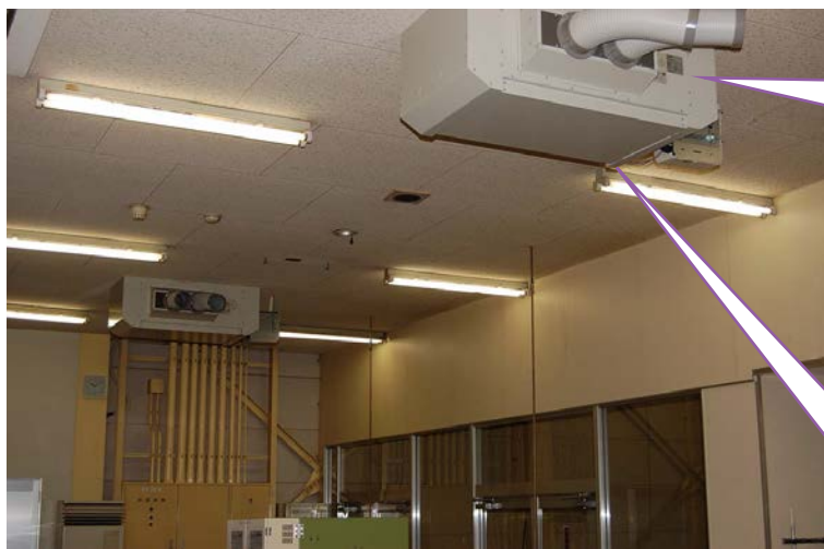
▲焼き工程に移る前の「供給室」にて天吊薄型タイプ除湿機KEH-P08Aを2台ご採用。既設の空調機と合わせて温湿度を管理。
