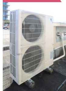
▲室外ユニットは屋上スペースに設置。
