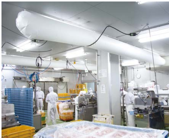
ソックダクト対応ユニットクーラが設置されたスライス作業室。室温は14℃に設定も快適な作業環境を実現!
