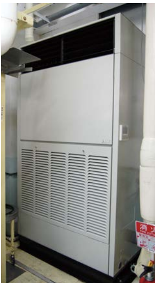
▲今回既設機器(当社従来機種 PA-10A)にかわってご採用いただいた設備PAC洗浄可能タイプ。
