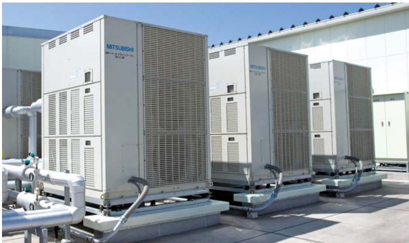
▲建屋東側(南面)の1階屋上に設置された一体空冷式インバーターブラインクーラ(BALV-P40AE×6台)。生地をつくる際のミキシングによる温度上昇を抑えるため、ミキサージャケットにブライン液を使用して冷却する。仕込水の冷却にも使われる
