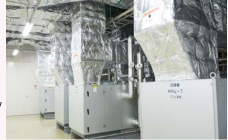
▶ 負荷側のエアハンドリング ユニット(AHU)
