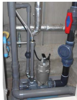
H-NS型 (ポンプ室内)
