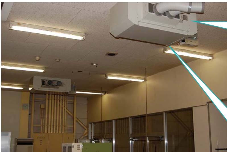
▲焼き工程に移る前の「供給室」にて天吊薄型タイプ除湿機KEH-P08Aを2台ご採用。既設の空調機と合わせて温湿度を管理。
