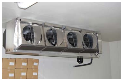
▲原料保管庫内には当社製冷凍用ユニットクーラを2台設置。原料の劣化を防ぐため-20℃で保管。
