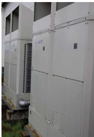
▲屋外には原料保管用冷凍庫の熱源機の当社製R410Aインバータコンデンシングユニット20馬力×2台
