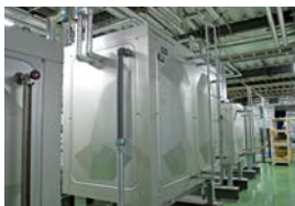
▲仕込水タンク
