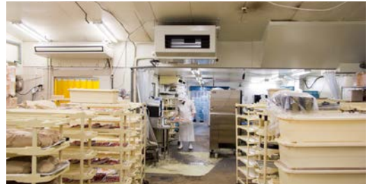
▲チェーン各店舗用の精肉パックを製造している精肉センター。その中央部に設置された「ハイブリッド式産業用除湿機」
