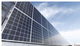
太陽電池モジュール
