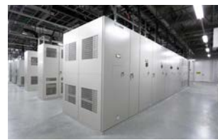
無停電電源設備(UPS)
