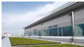
屋上緑化設備
