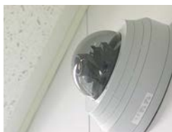
監視用モニターカメラ
