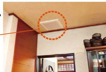
メインルームのCO 2 センサー搭載ダクト用換気扇(VD-20ZAGVX 5 -C)。こちらDCブラシレスモーターを搭載している
