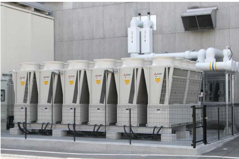
▲第4鋳造工場内の作業員に対する温熱環境改善として採用した空冷式ヒートポンプチャラー「DT-RⅢ」
