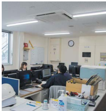
▲事務所に採用された空調機も三菱電機製
