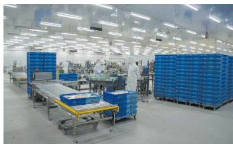
▲エア搬送ファンを導入して、大空間に気流を発生させ、換気・空調効率を向上
