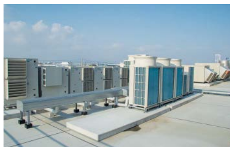
▲コンデンシングユニットは屋上と工場脇の2ヶ所に集中設置 (写真は屋上)
