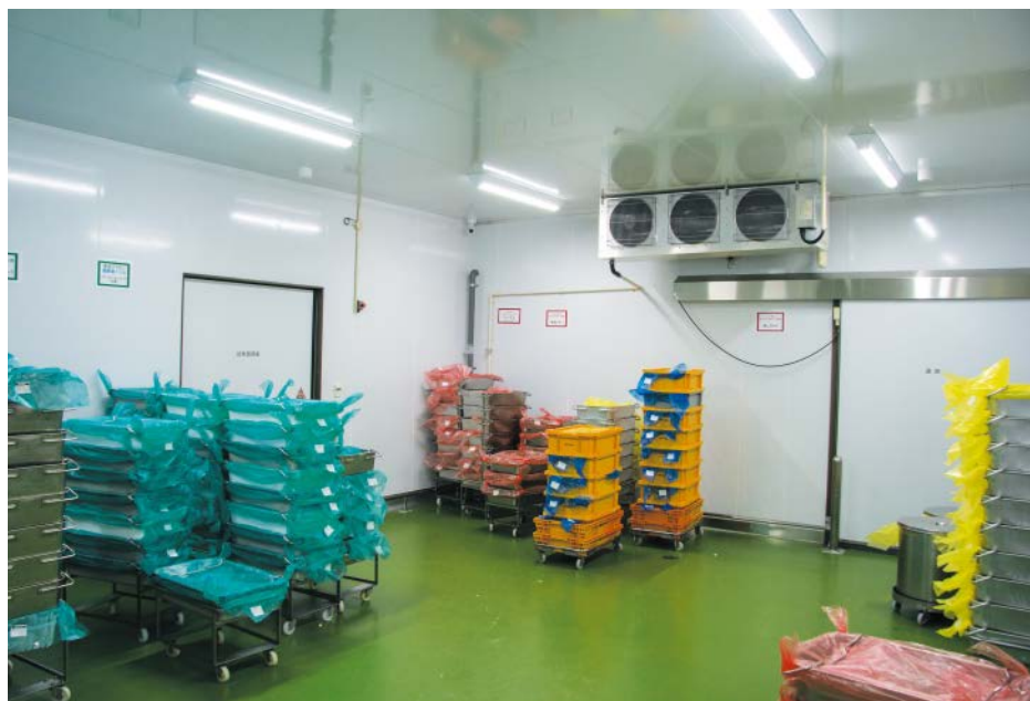
▲塩分濃度の高い半製品冷蔵庫には腐食に強い熱交換器配管厚肉仕様のユニットクーラを採用
