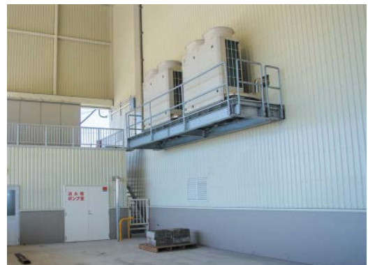
▲災害対策で高所設置されたコンデンシングユニット(中央)とキュービクル(左)
