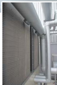
▲地下ピット内の冷気を熱源機吸込み側に取込むことによる夏季省エネへの期待は大きい
