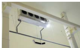
▲ユニットクーラとエア搬送ファンの設置場所は気流を考慮して決定
