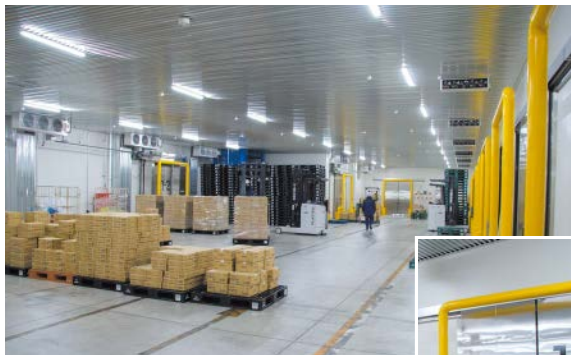
▲荷捌室の温度は5℃設定。結露対策に三菱電機製エア搬送ファンを導入
