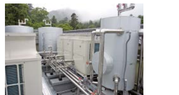
▲ 屋上に設置された業務用エコキュート×3。貯湯槽 (左奥) は密閉型の 6t×3。更新前は開放型だったが、スペース対応で密閉型が採用された。手前はホットウォーターヒートポンプの加熱昇温用循環槽 (1 t)
