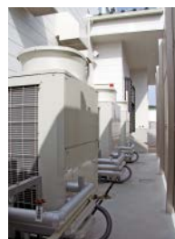
◀工場と駐車場の間にあるわずかなスペースを利用して設置
