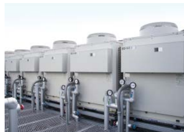
▲浴室用の業務用エコキュート×6台
