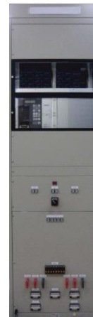
電力系統用保護リレー盤
