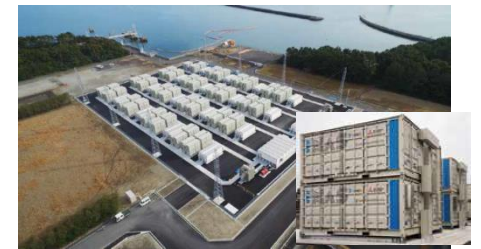
蓄電池制御システム
