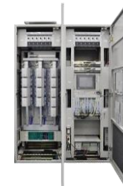
水カプラント制御装置
