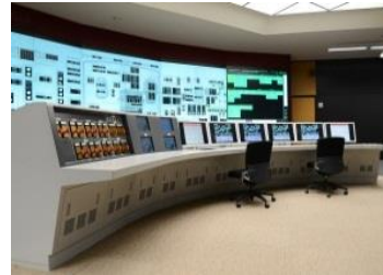
原子力発電プラント 総合デジタル 計装制御システム
