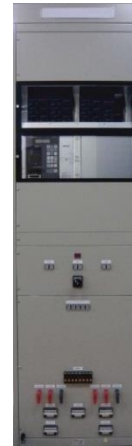
電力系統用保護リレー盤
