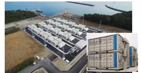
蓄電池制御システム
