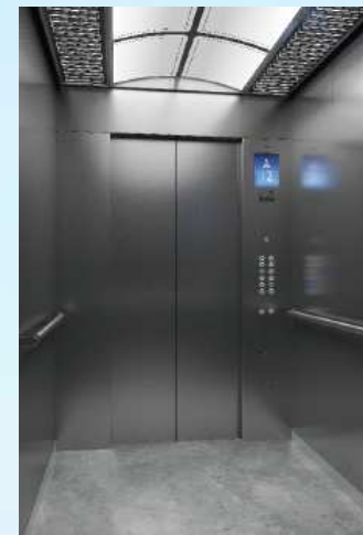
LEHY SMEC製 機械室付 エレベーター
